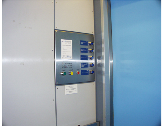
20. Winsløvparken, elevator i bygning 21
